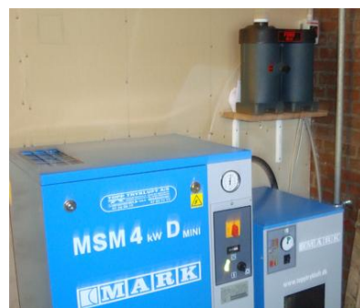
Miljøren Puro Mini monteret på væg
